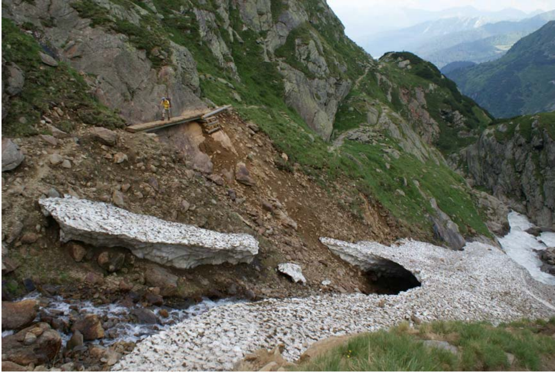
Abb. F- 6: Beispiel einer aufwändigen Wegsanierung durch Einbau einer Hangbrücke nach flächenhaftem Abgleiten des ursprünglichen Hanges auf Grund dessen Unterschneidung durch das im Vordergrund sichtbare Gerinne (Ridnauntal, Stubaier Alpen) (Foto: G. K. Lieb, 15.7.2010).
